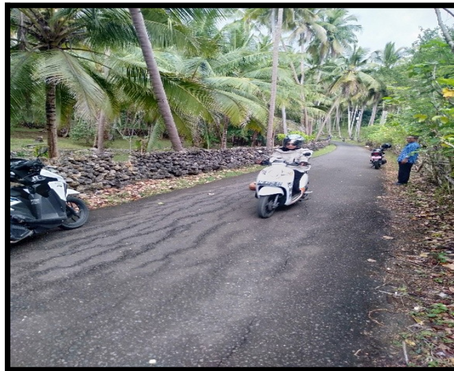
Gambar: 1.13 Kondisi jalan di Kecamatan Bontosikuyu
